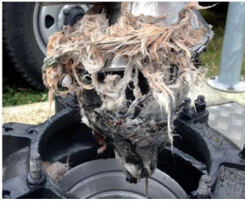
Verstopfte Pumpen, aufwändige Instandstellung.
